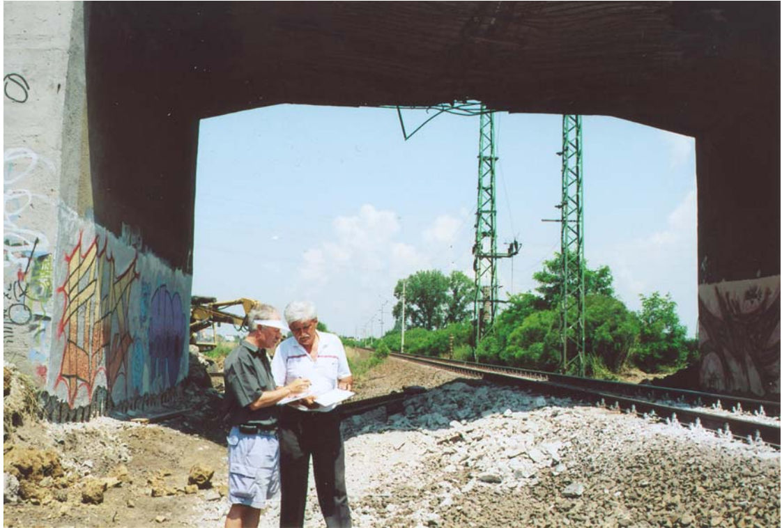
A baloldali pilléren jól láthatók a kibontott betonacélok
